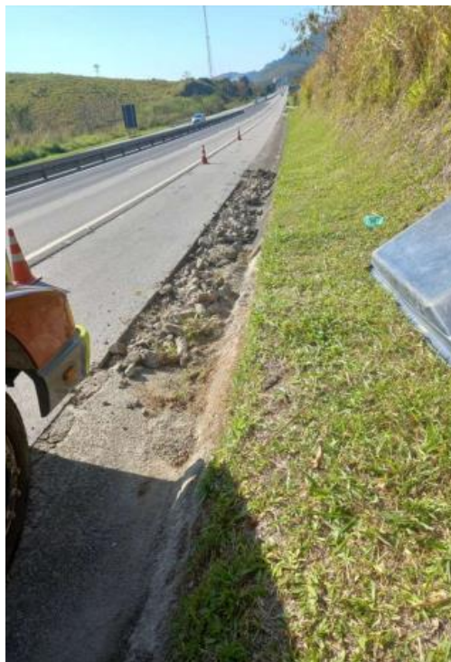
Figura 4.6 Via Lagos - Recuperação de Sarjeta - Km 11+100 Norte
